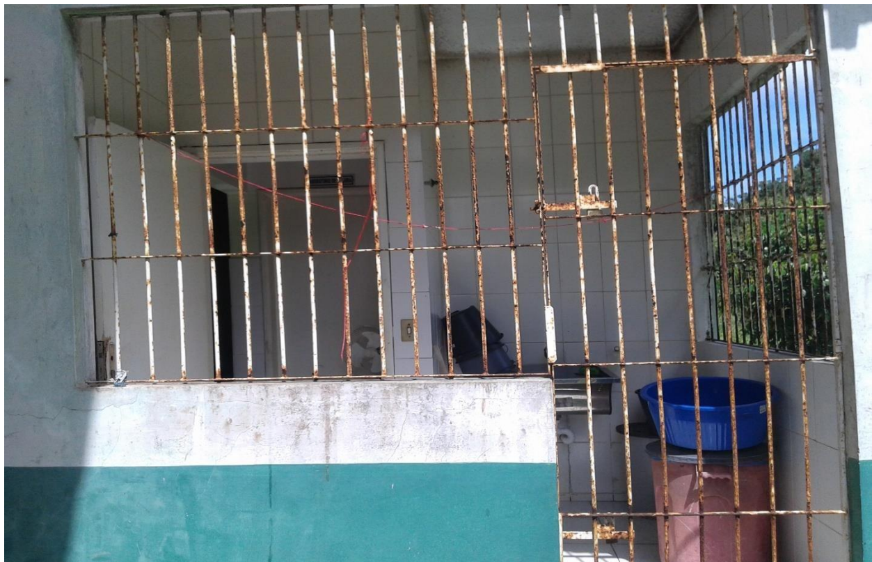
Reg. fotográfico da situação-Engenharia e Fiscalização/SEPLAN/PMB
