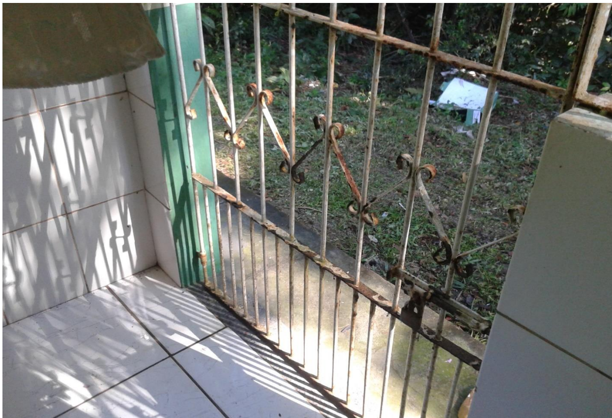
Reg. fotográfico da situação-Engenharia e Fiscalização/SEPLAN/PMB
