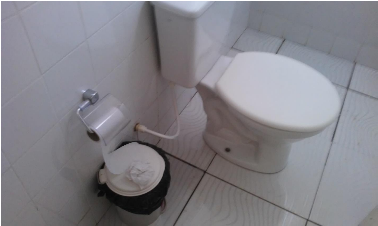
Reg. fotográfico da situação-Engenharia e Fiscalização/SEPLAN/PMB
