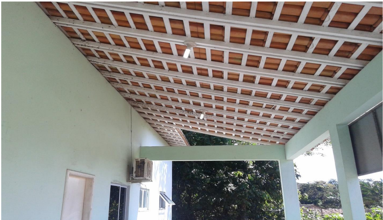
Reg. fotográfico da situação-Engenharia e Fiscalização/SEPLAN/PMB
