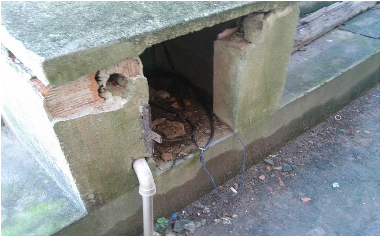
Reg. fotográfico da situação-Engenharia e Fiscalização/SEPLAN/PMB
