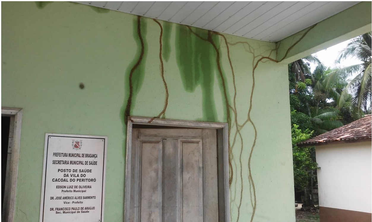
Reg. fotográfico da situação-Engenharia e Fiscalização/SEPLAN/PMB
